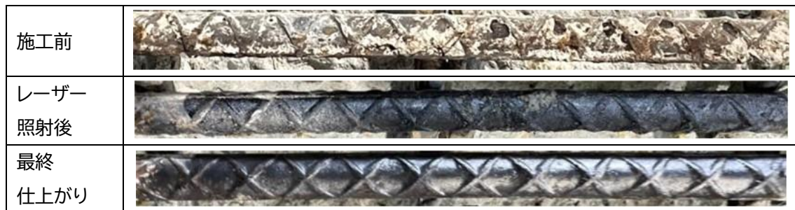
写真-5 ケレン前後の鉄筋状態
